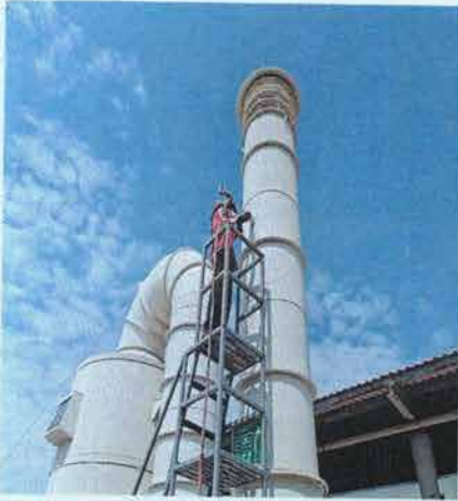
DA022 废气处理后采样口
