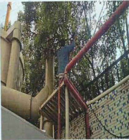
DA031 废气处理后采样口
