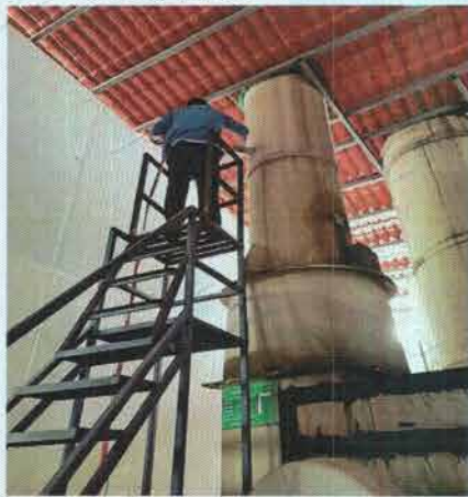
DA001 废气处理后采样口
