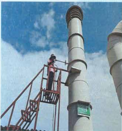
DA010 废气处理后采样口
