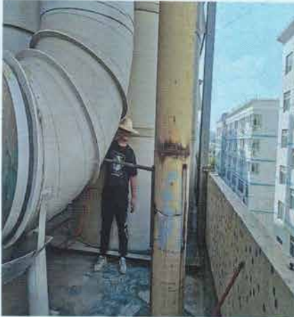
DA025 废气处理后采样口
