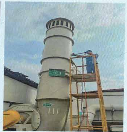
DA006 废气处理后采样口
