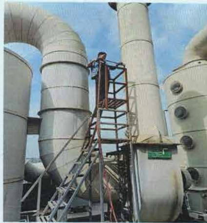
DA008 废气处理后采样口
