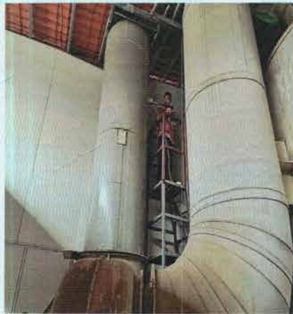
DA002 废气处理后采样口
