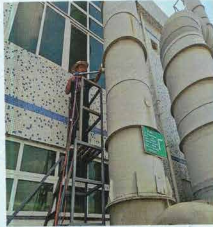
DA014 废气处理后采样口
