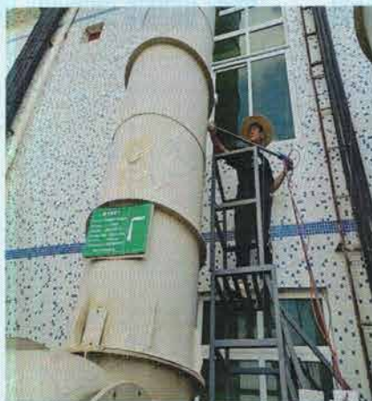
DA020 废气处理后采样口
