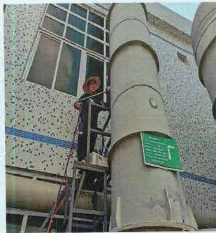
DA033 废气处理后采样口
