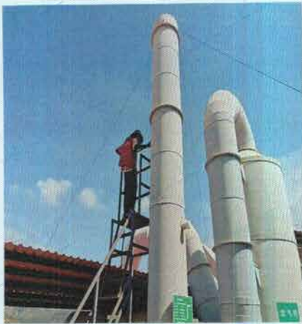
DA016 废气处理后采样口
