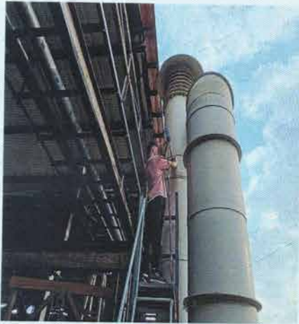
DA004 废气处理后采样口
