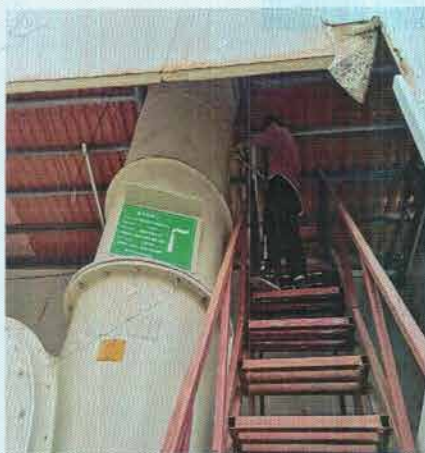
DA019 废气处理后采样口
