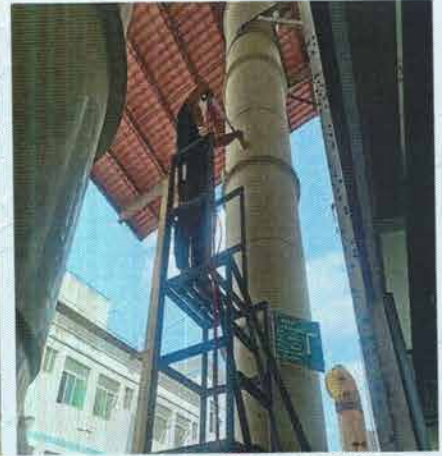
DA015 废气处理后采样口
