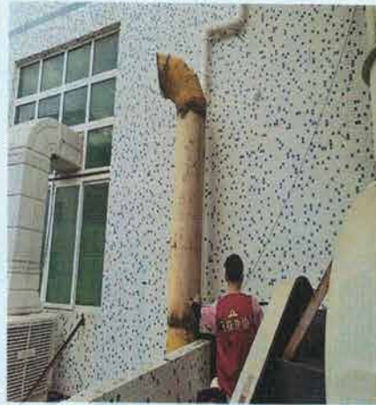
DA026 废气处理后采样口
