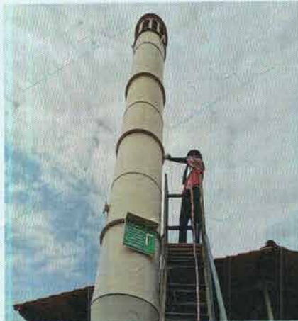
DA017 废气处理后采样口
