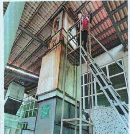
DA018 废气处理后采样口
